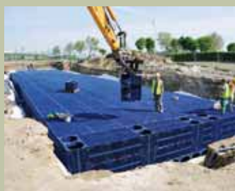
Citerne de récupération d'eau de pluie,
